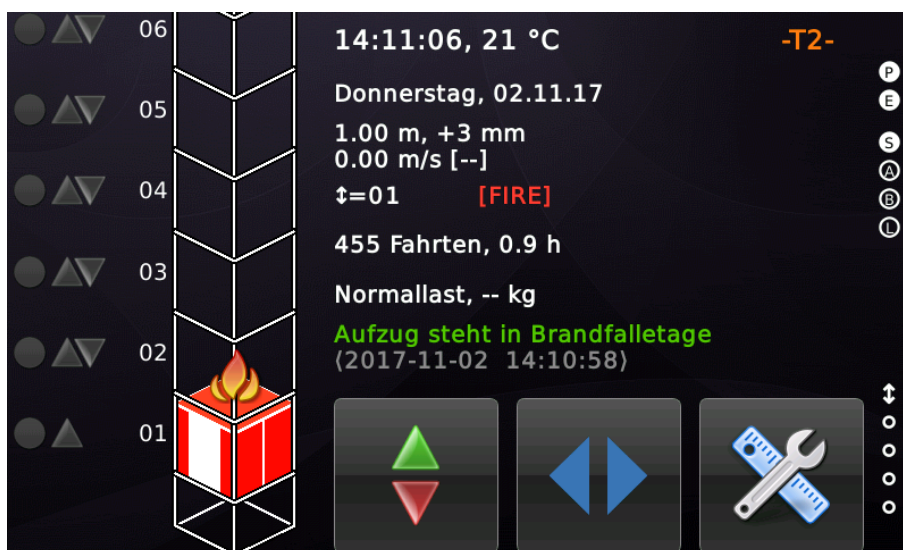
Abbildung 141: Aufzug im Brandfallbetrieb
